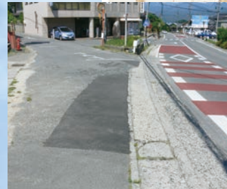
枡形のなごり。 右側の車輦道路でクラック部は解消されました。
