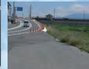
河川区域上の道路のため、ガードレールは付けられない。代わりにポストフレックスが並ぶ。
