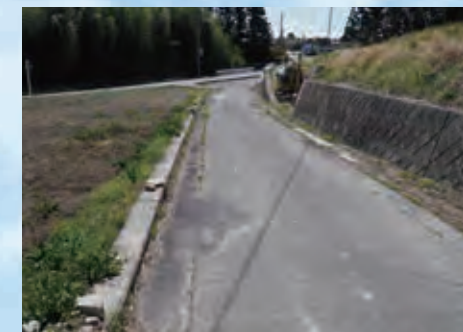
広域農道の開設によりスポット的に生まれた廃道区間。
