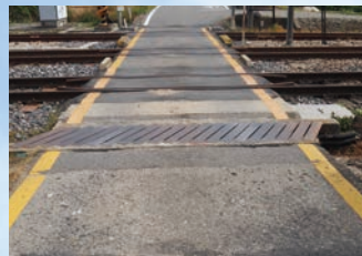
踏切に廃レールが再利用されている
