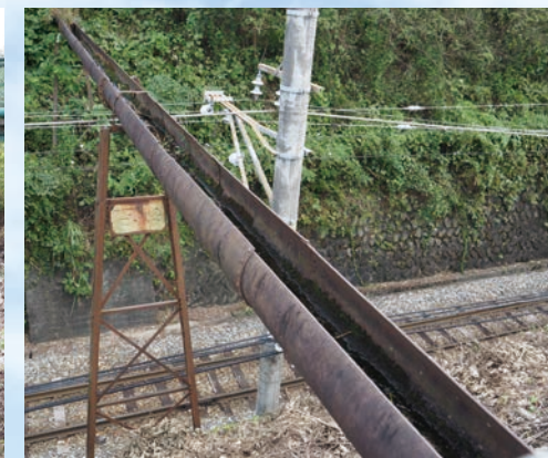
水管を官営八幡製鉄所製の廃レールが支えている
