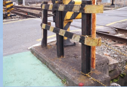
市田踏切の防護柵
